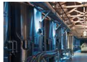
REFRIGERAÇÃO DE PROCESSO
